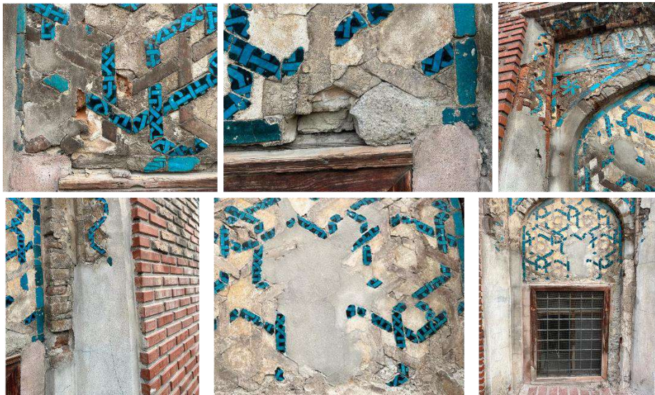
Görsel 10. Onarımlar ile Ortaya Çıkan Bozulmalar.
