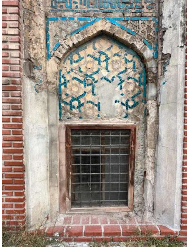
Görsel 7. Çinilerde Görülen Birim Malzeme Kayıpları.
