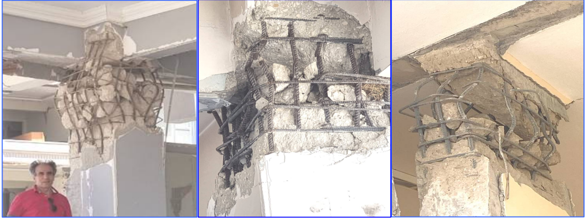
Görsel 7. Dikdörtgen kesitli kolonlarda deprem hasarı
