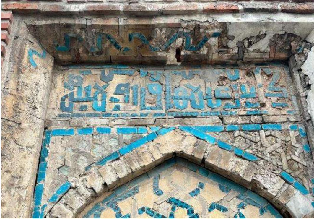
Görsel 6. Çinilerin Bağlayıcı ve Derz Dolgu Harçlarında Oluşan Bozulmalar.
