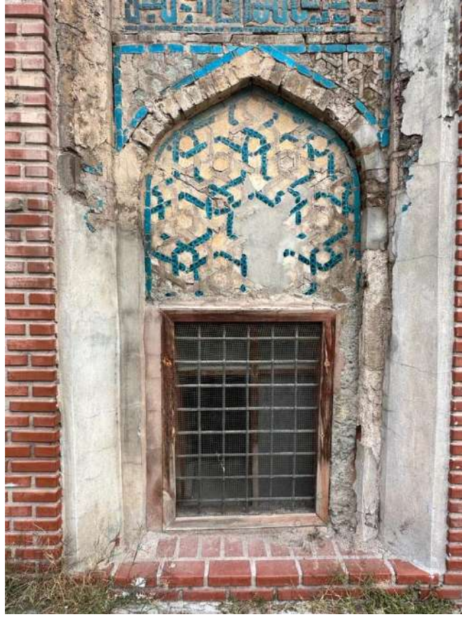
Görsel 7. Çinilerde Görülen Birim Malzeme Kayıpları.
