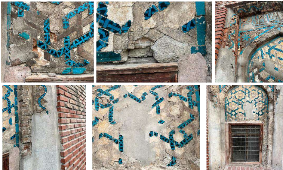
Görsel 10. Onarımlar ile Ortaya Çıkan Bozulmalar.
